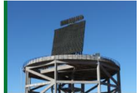
Instalación fija sobre torre
